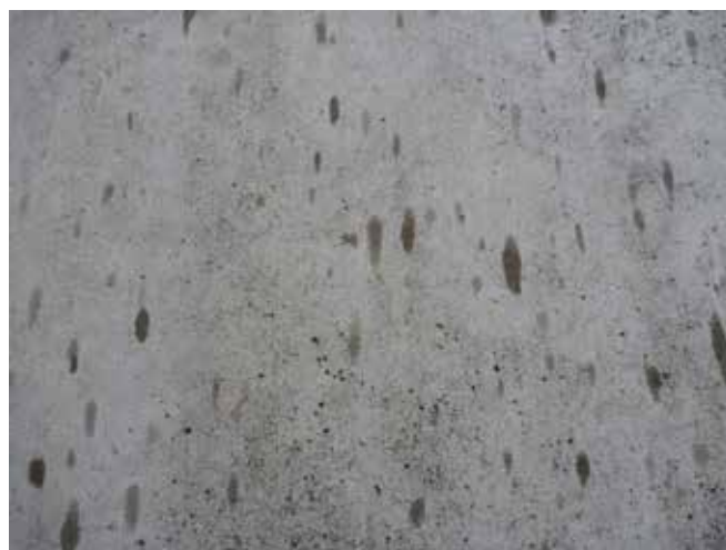
写真-2 防波堤側面のコンクリート表面近影（透水型砕の様態が見える）
