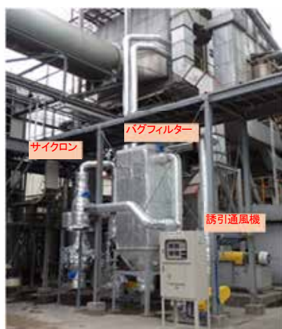
Fig.10 サイクロン実証試験設備全景
